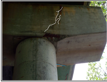
(d) 盖梁裂缝
